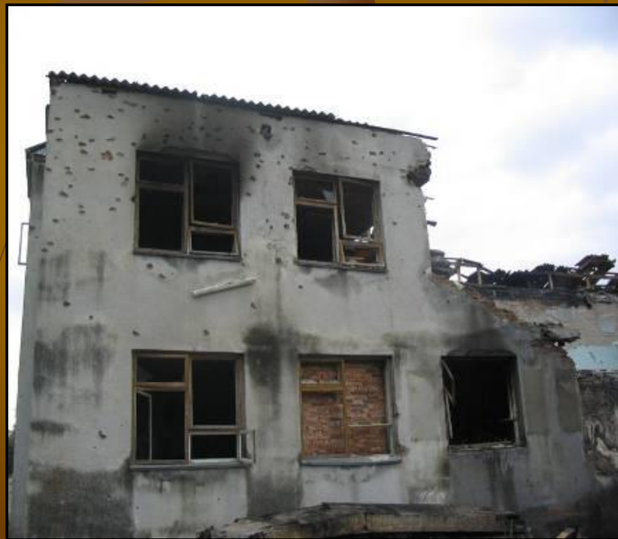
Школа, разрушенная в ходе теракта.
